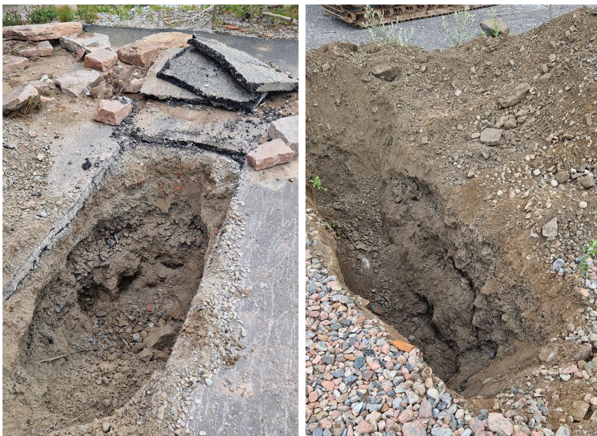
Figur 1. Markprofil i provgropar 2307 (t. v.) och 2308 (t.h.), ca 1,2 m djup med inslag av tegel, sten och block.
